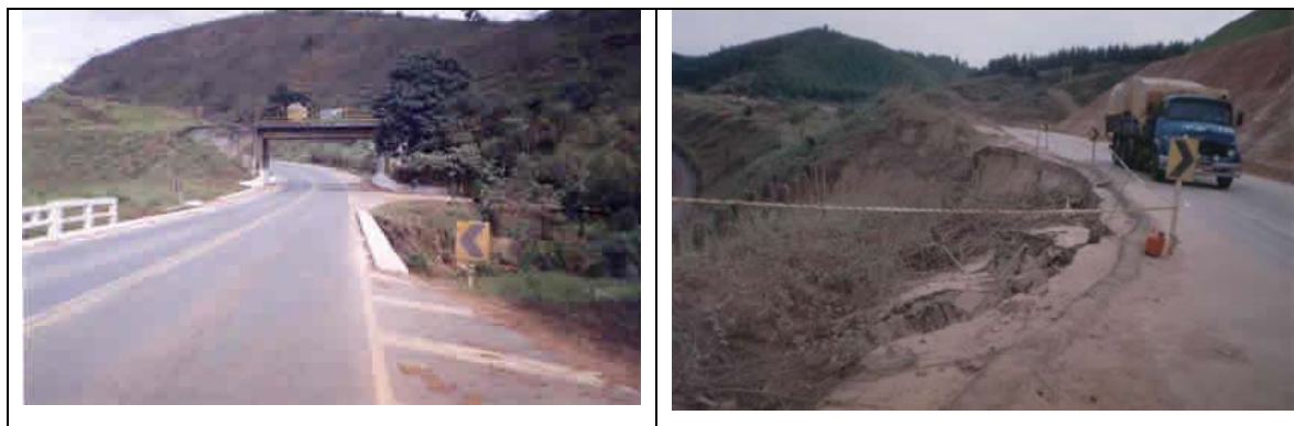
Figura 32 – Trechos da rodovia SP-381, ilustrando condição de pavimentação
