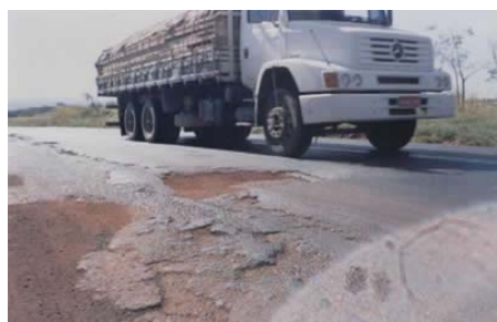
Figura 30 – Trechos da rodovia BR-153, ilustrando condição de pavimentação
