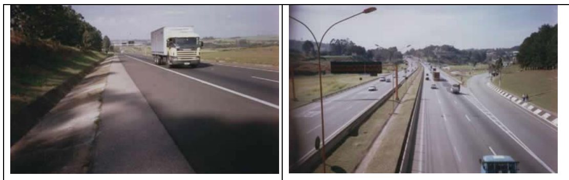
Figura 36 - Trechos da rodovia SP-280, ilustrando condição de pavimentação
