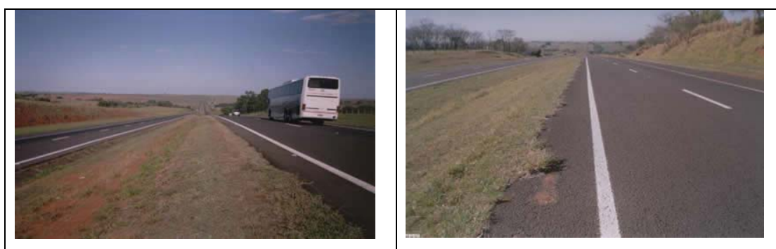
Figura 35 – Trechos da rodovia SP-300, ilustrando condição de pavimentação
