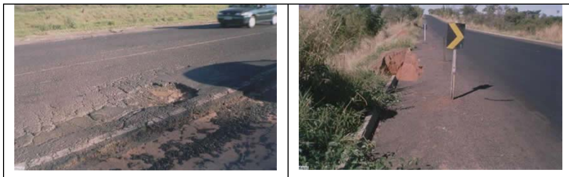
Figura 29 – Trechos da rodovia BR-153, ilustrando condição de pavimentação
