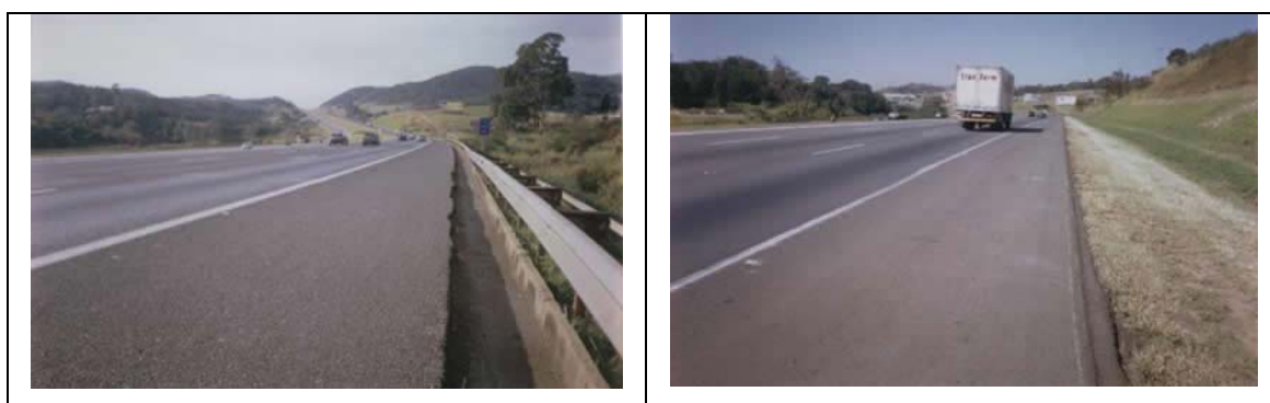
Figura 25 – Trechos da rodovia SP-348, ilustrando condição de pavimentação
