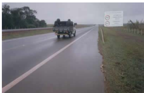
Figura 28 – Trecho da rodovia SP-322, ilustrando condição de pavimentação
